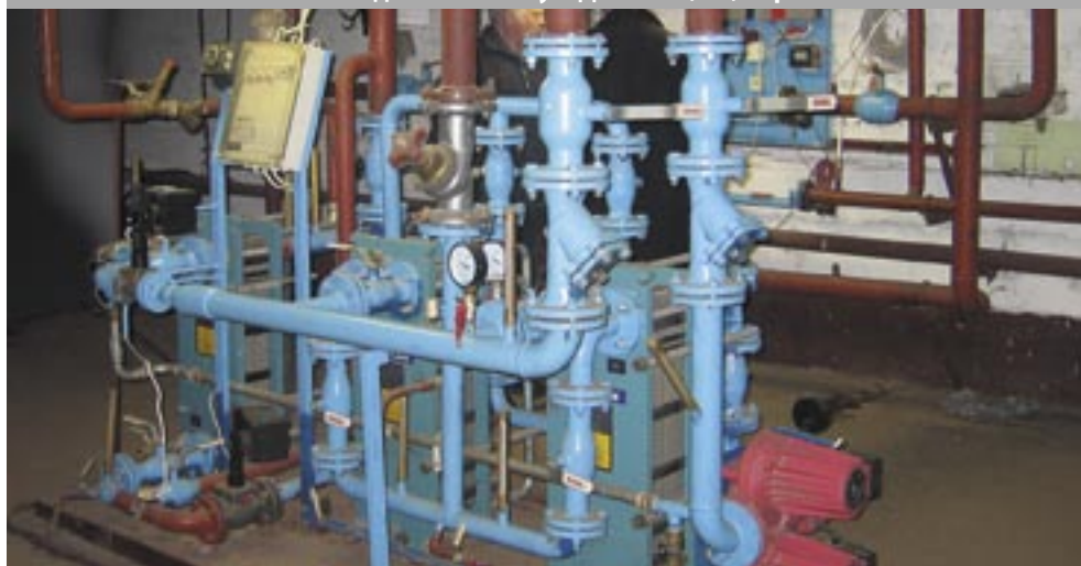
Рис. 2. Автоматизированный индивидуальный тепловой пункт в жилом доме ЖСК по ул. Дыбенко, 25, корп. 2
