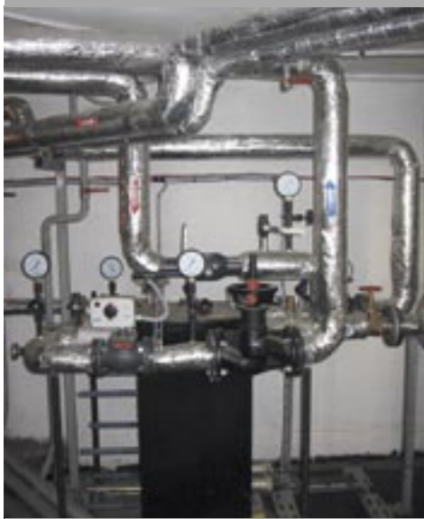
Рис. 1. Тепловой пункт одного из домов в районе Ржевка-Пороховые
