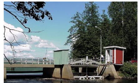
Kläggen, Suède • Installateur: Olab AB.
