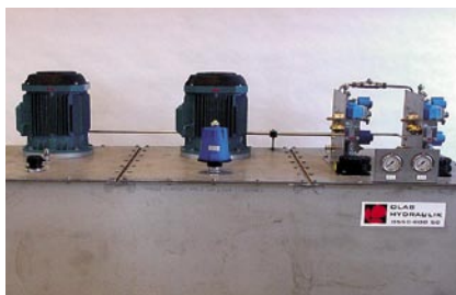
Degerfors, Suède • Installateur: Olab AB.
