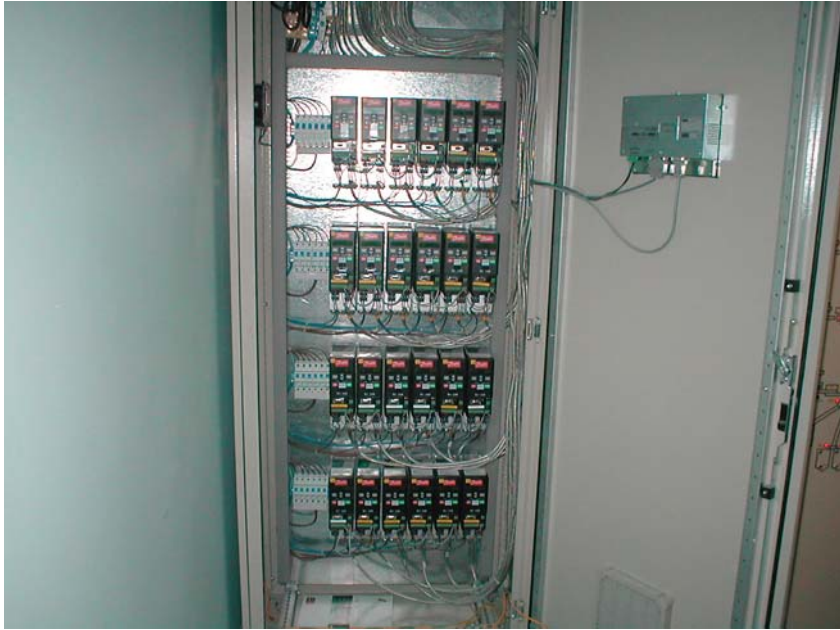
Rys.2 Szafa 24 przetwornic połączonych interfejsem RS 485.
