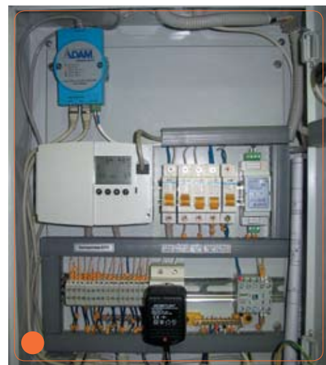
Рис. 2. Шкаф с коммуникационным сервером
