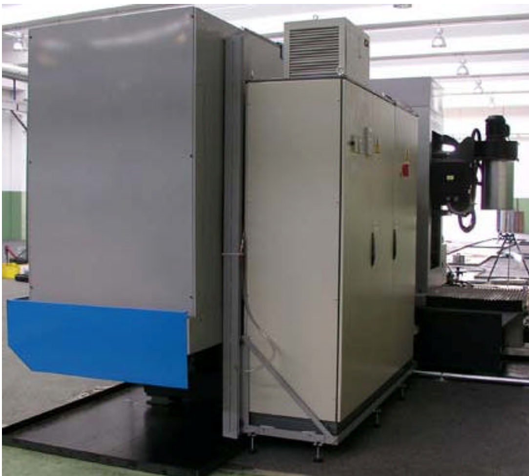
Effettuata l'installazione della macchina, il quadro elettrico, a essa solidale, si distanzia di qualche millimetro, in modo da non risentire delle vibrazioni indotte dalla rettifica durante il funzionamento
