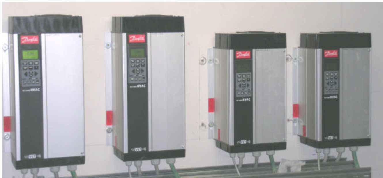
Inverter Danfoss serie VLT® 6000 HVAC, protezione IP54, per le UTA delle sale operatorie.
